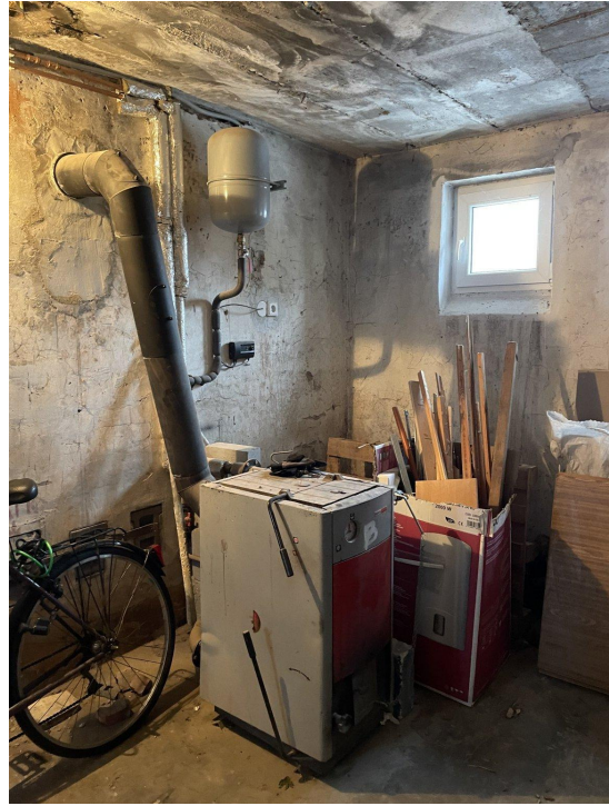
původní kotel ve sklepě
