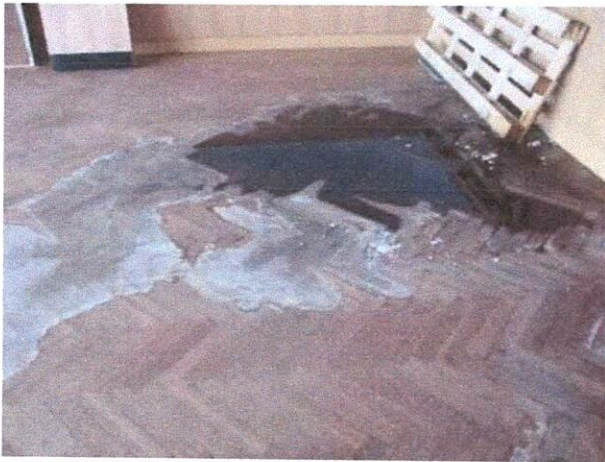
Zatékání do velkého sálu
