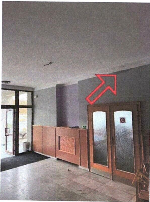
Zatékání - vstupní chodba
